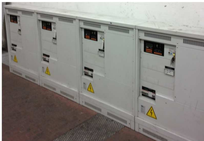
Galleria Cels - regolatori di flusso luminoso cabina TL13
