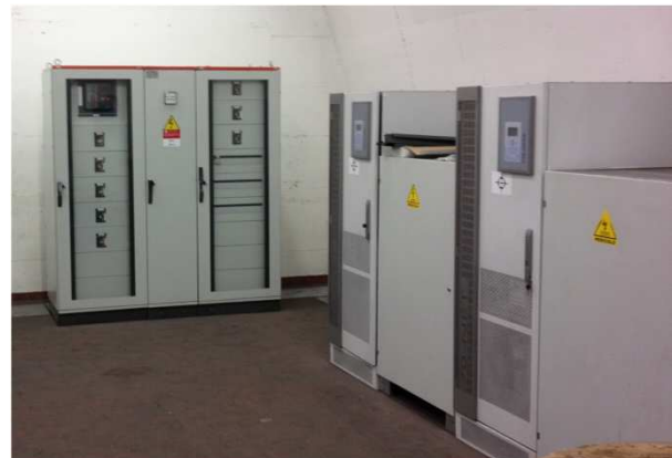
Nuovi quadri di distribuzione cabina TL13
